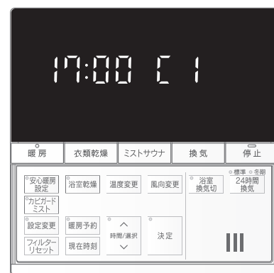
(脱衣室リモコン)
