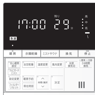
(脱衣室リモコン)
