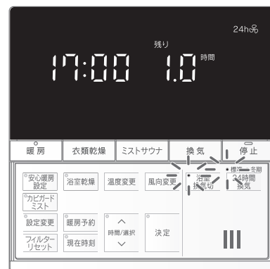
(脱衣室リモコン)
