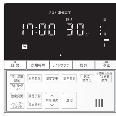
(脱衣室リモコン)
