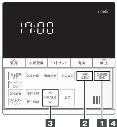
脱衣室リモコン
