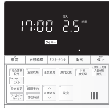
(脱衣室リモコン)
