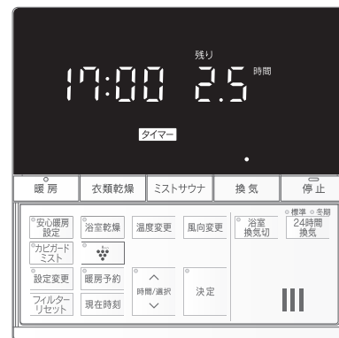
(脱衣室リモコン)
